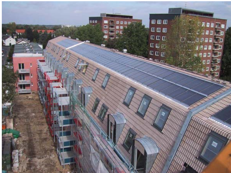
Abb. 14 Die Solaranlage auf dem Projekt Bilderstöckchen
