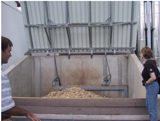
Abb.10 Spänebunker im Projekt Bad Neuenahr, so ausgelegt, dass eine komplette LKW Ladung untergebracht werden kann
