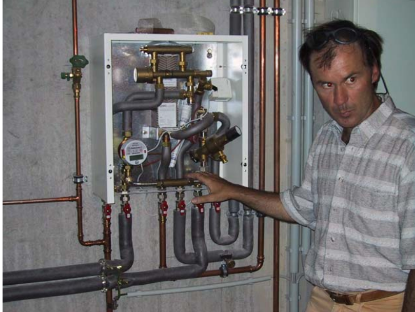
Abb. 9 Die Unterverteilungen in den Häusern, Wärmesatelliten mit Wärmemengenzähler, Plattenwärmetauscher für die Warmwasserbereitung und Strangregulierung für die Heizungsanlage.
