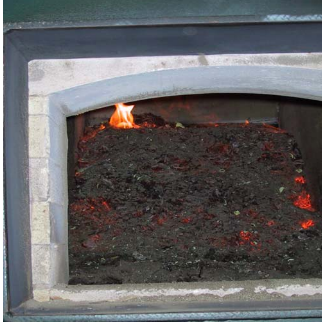
Abb. 11 Blick in den Kesselbrennraum im Betriebszustand Gluterhaltung.
